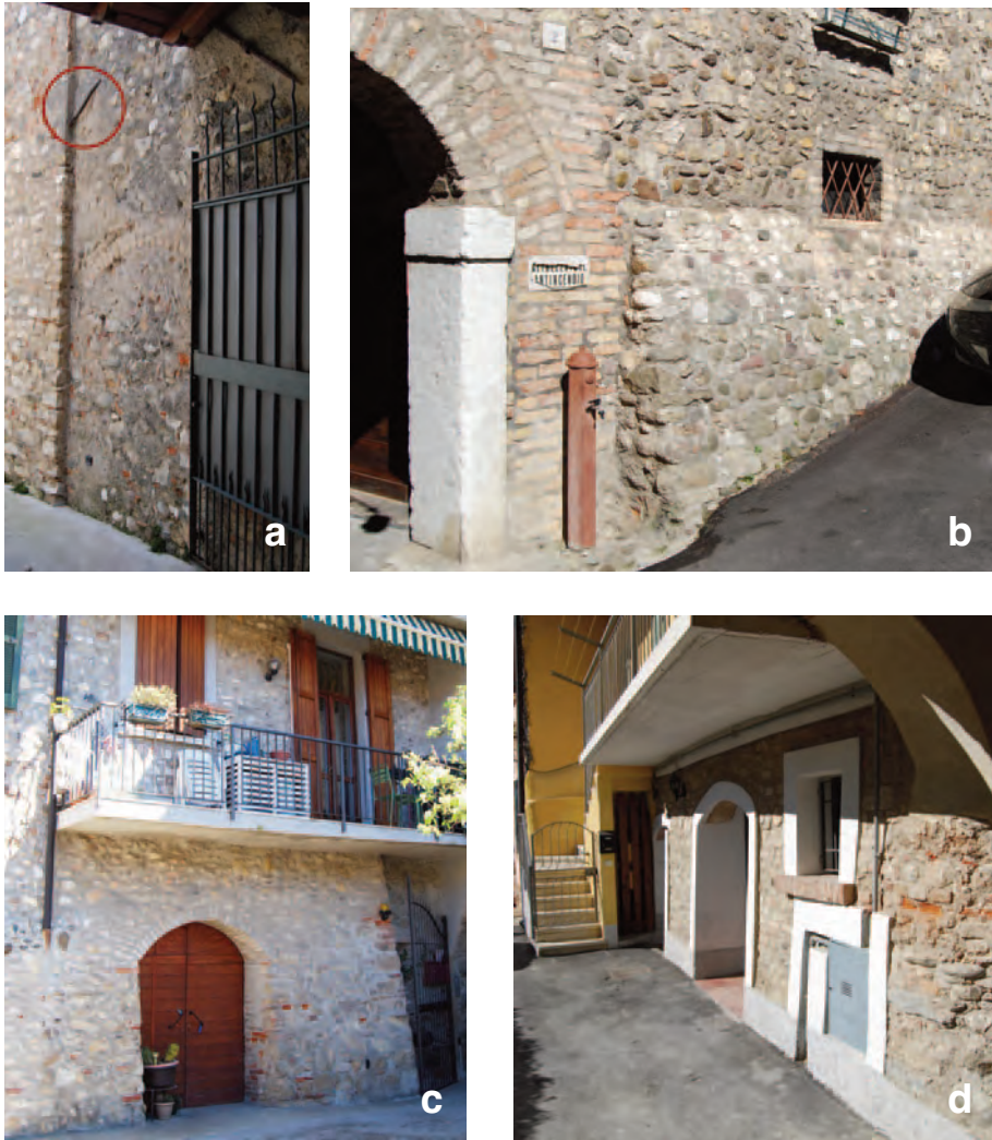
Fig. 70. a) Muri a scarpa MS 15, il quale copre un capochiave e presenta tessitura con conci sbozzati (Via Mazzini); b) MS 20 in appoggio e con tecnica muraria in ciottoli (Via Cavour); c) MS 21 in appoggio e con muratura in pietrame (Via Cavour); d) MS 22 (Via della Luna).
