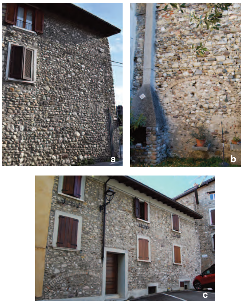
Fig. 33. Esempi di unità resistenti costituenti le murature degli edifici nel centro di San Felice del Benaco: a) ciottoli; b) ciottoli e mattoni; c) pietrame.
