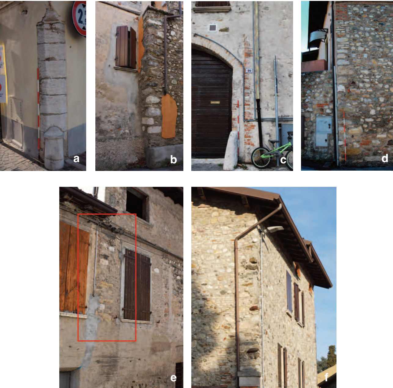
Fig. 52. Esempi di cantonali realizzati con diversi materiali: a) Botticino, elemento C 12 all'incrocio tra Via Marconi e Via XX Settembre; b) Botticino misto ad altri tipi, C 8 in Via Garibaldi; c) laterizi, C 22 in Via Mazzini; d) Botticino, tufo calcareo e laterizi, C 26 in Via Cavour; e) medolo, C 11 in Via Cavour; f) ciottoli di lago spaccati, C 17 in Via Marconi.
