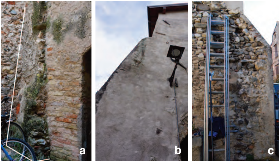
Fig. 62. Esempi di contrafforti: a) CONTR 1 in pietrame addossato alla parete (Via Garibaldi); b) CONTR 8 misto in pietra e mattoni addossato alla parete (volto di Via Romana); c) CONTR 6 in ciottoli in fase con la muratura (Via Zanardelli).
