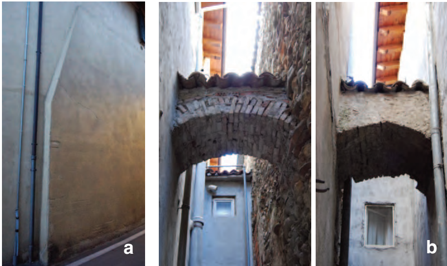
Fig. 61. Esempi di a) Ringrosso murario RM 1 in Via Marconi; b) archi di sbadacchio all'interno di un edificio in Via Cavour.
