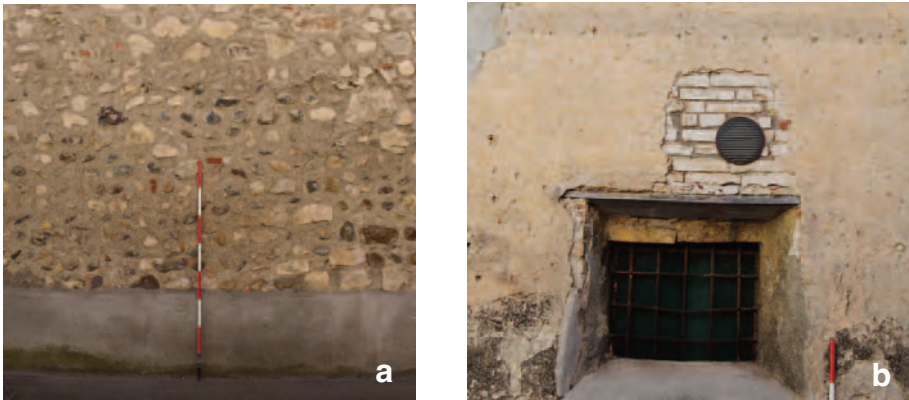
Fig. 38. Interventi strutturali sulle murature: a) ristilatura dei giunti; b) scuci-cuci in laterizi pieni.
